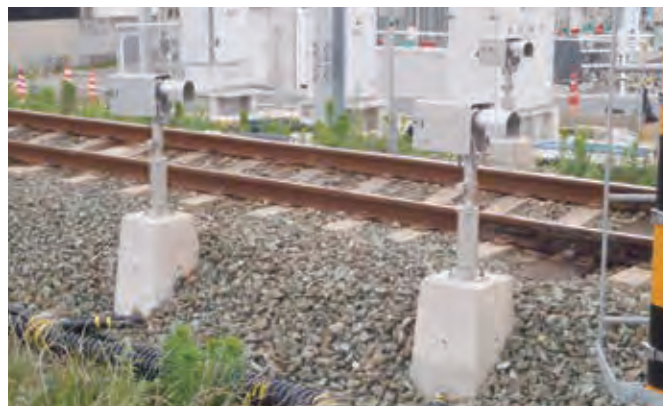
踏切障害物検知装置
