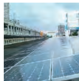
太陽光パネル(宇多津駅)
