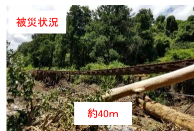
④下宇和・立間間284k380m 盛土崩壊
